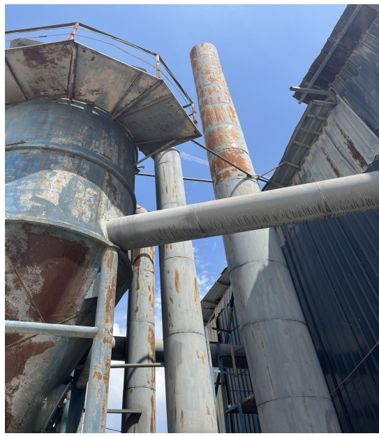
石料破碎筛分工段粉尘排气筒
