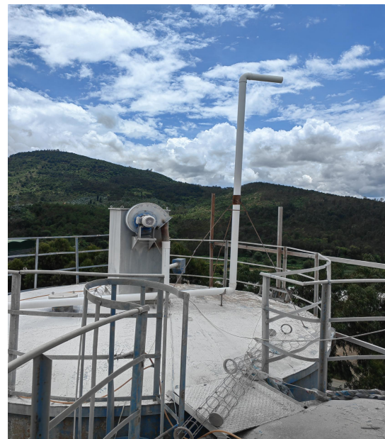
细粉料筒仓呼吸粉尘排气筒2#
