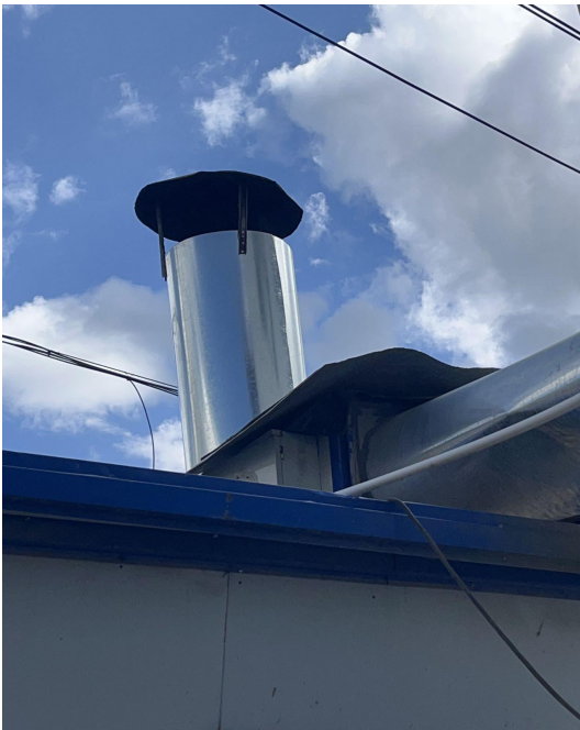
食堂油烟排气筒
