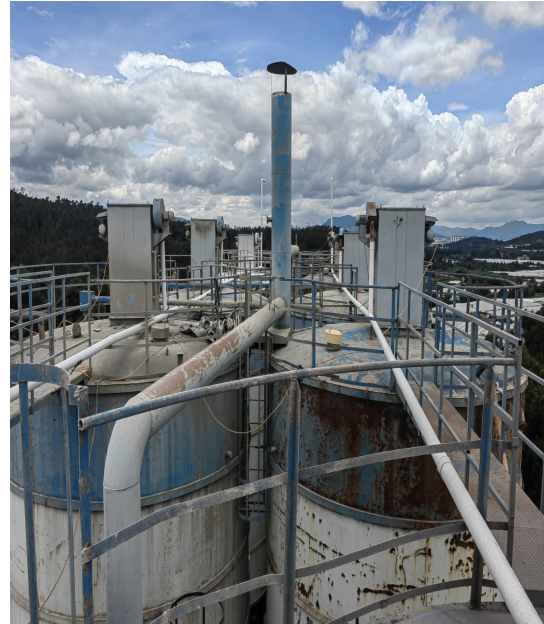
搅拌粉尘排气筒
