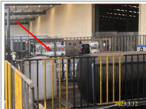
新增反渗透过滤装置
