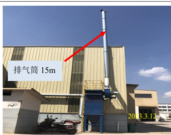
混粉车间新增布袋除尘器
