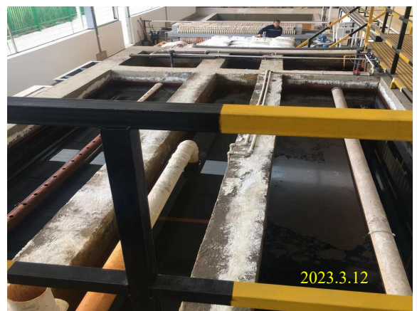
依托利用污水处理站
