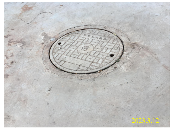
依托利用化粪池
