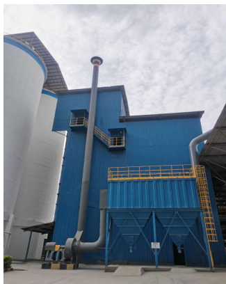
改造后的 25 米排气筒
