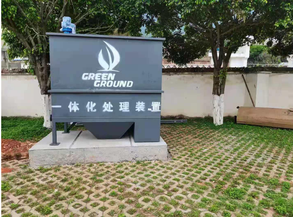
一体化污水处理设施
